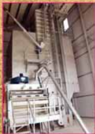
IMPIANTO ESSICCAZIONE 4 RR 6/4 BPN DA 45 TON
