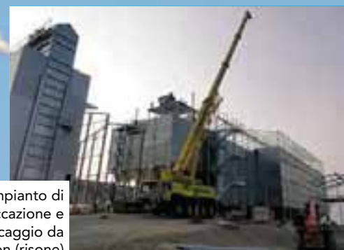
Impianto di pulizia, essiccazione e stoccaggio con silos verde
