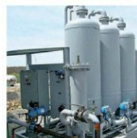
Un impianto di biogas
